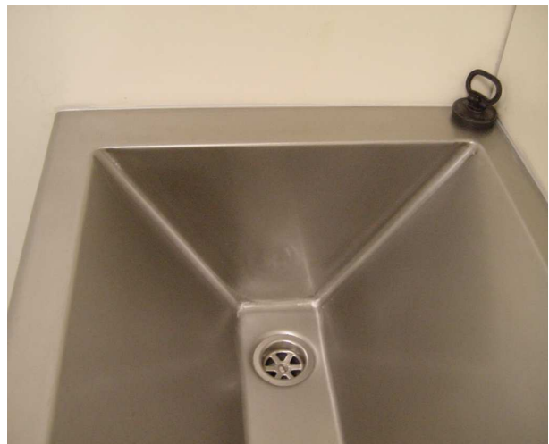
DETALLE DEL ACABADO INTERIOR DEL LAVAMANOS
